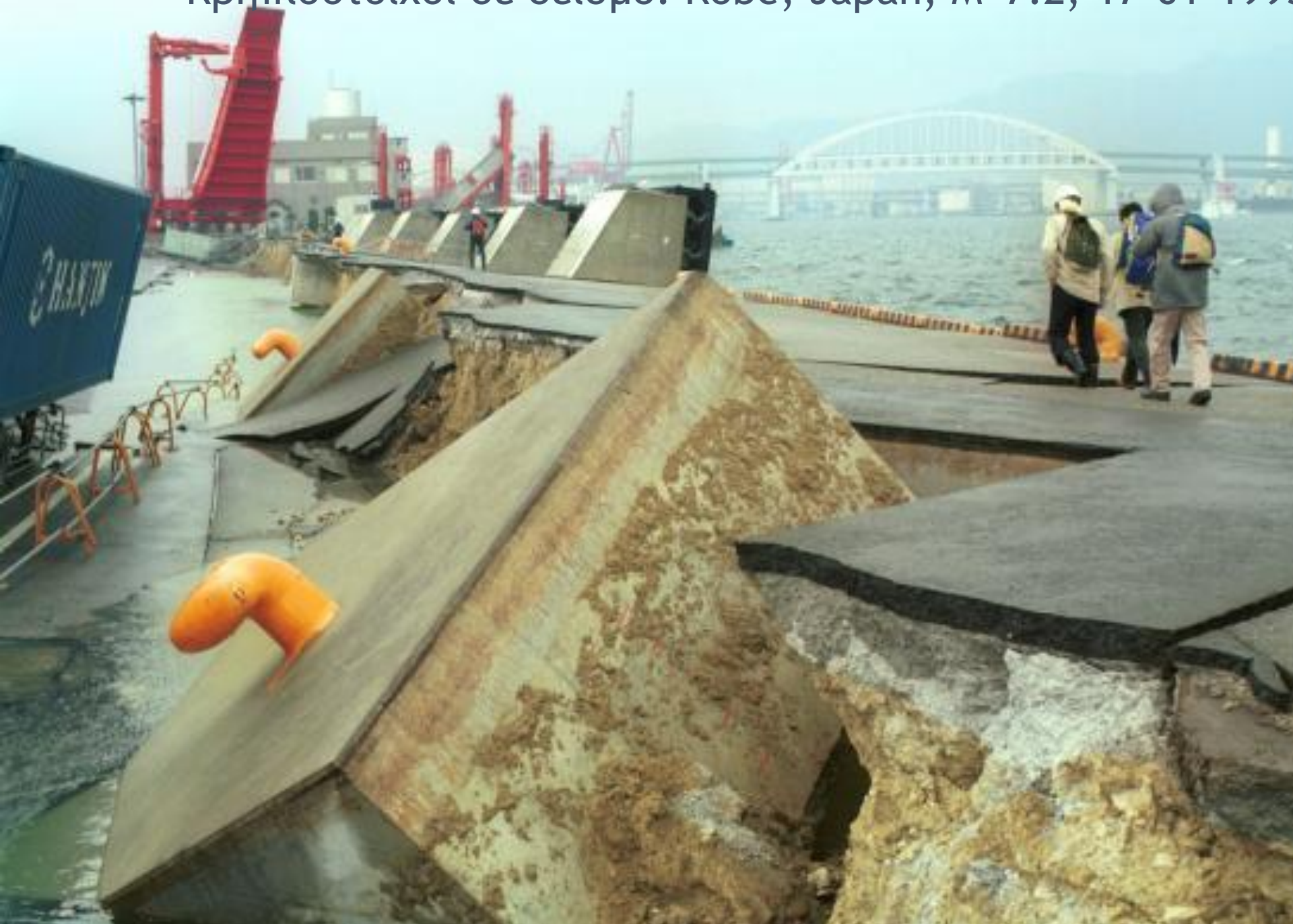
Κρηπιδότοιχοι σε σεισμό: Kobe, Japan, M=7.2 , 17-01-1995
